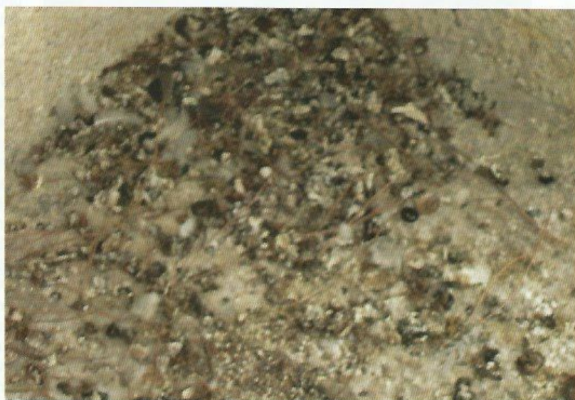
Evidente accumulo di guano.
